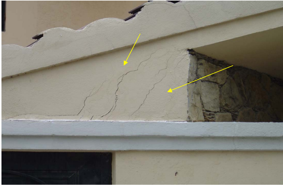
Fotografía 7.7a. Fracturas producto del empuje del bloque sobre la casa.
