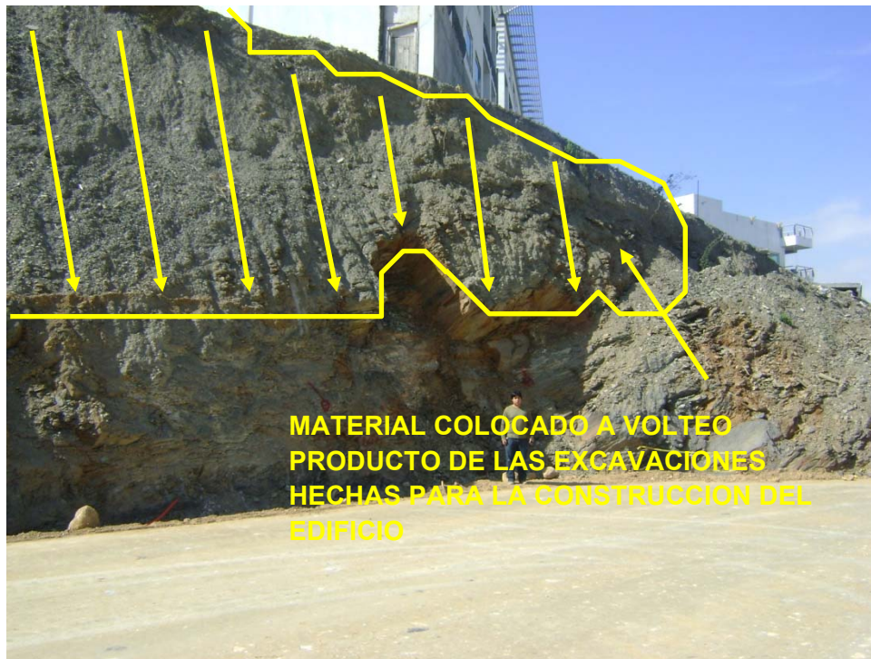
Fotografía 7.5.7.2.1.1. En esta fotografía apreciamos las dimensiones del descalce.
