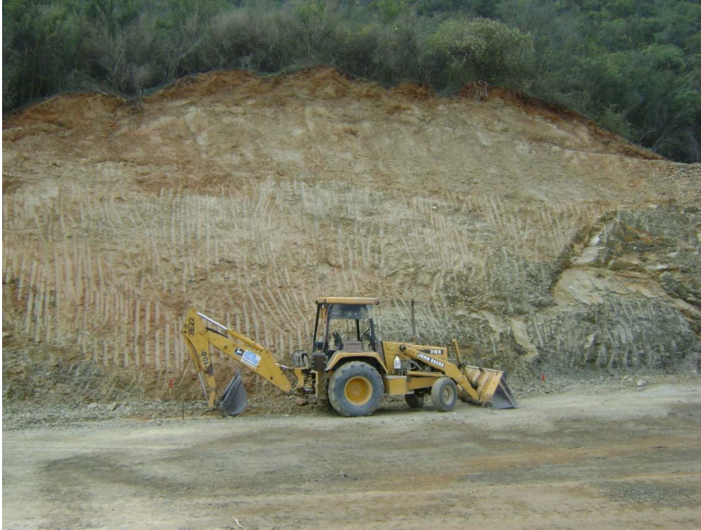
Fotografía 7.5.7.2.6.1. Talud recostado en el fraccionamiento.
