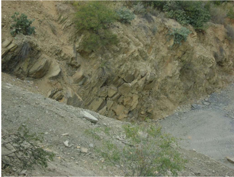
Fotografía 7.5.7.2.7.1. Un acercamiento de la imagen anterior. El estrato rocoso aflora casi inmediatamente en la superficie del talud. En algunas secciones se observa el efecto del intemperismo.
