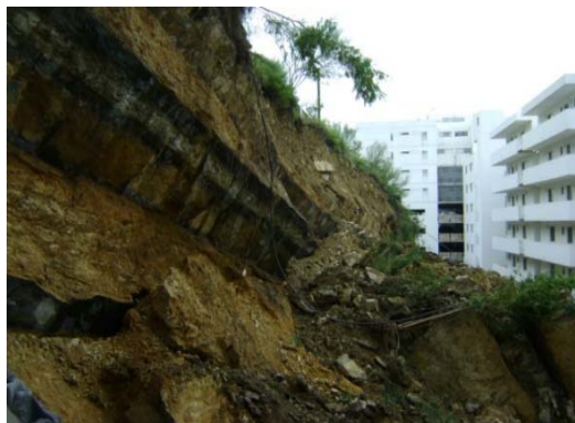
Fotografía 3.2.2. Daños generados por deslizamiento del talud en edificio Santa Fe I, después de las lluvias torrenciales que azotaron la ciudad de Monterrey y su área metropolitana los días 24 y 25 de Septiembre del 2010.
