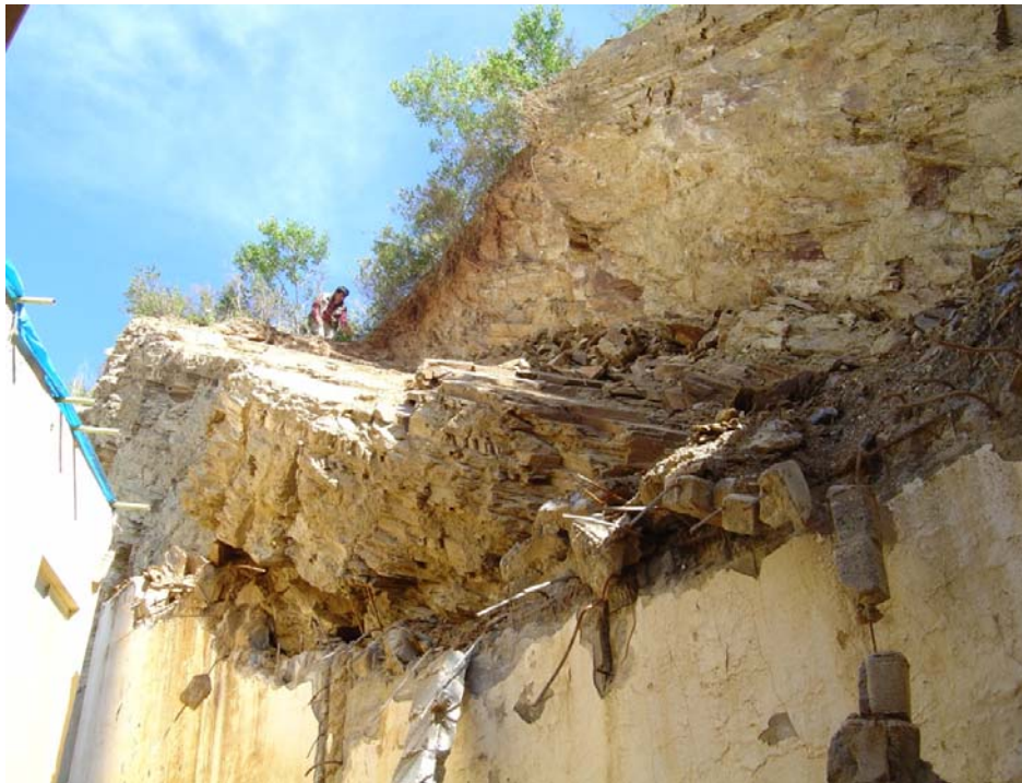
Fotografía 7.7d. Vista del talud que se deslizó sobre la casa habitación en el Fraccionamiento Bosques del Campestre, San Pedro Garza García, N.L.
