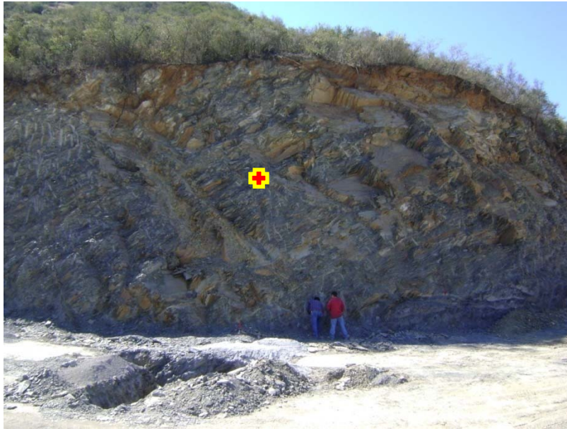
Fotografía 7.5.4b. Intemperismo severo y fracturamiento, se observa en el talud 0+000. La opción más viable como medida de mitigación es una línea de anclaje (✚).
