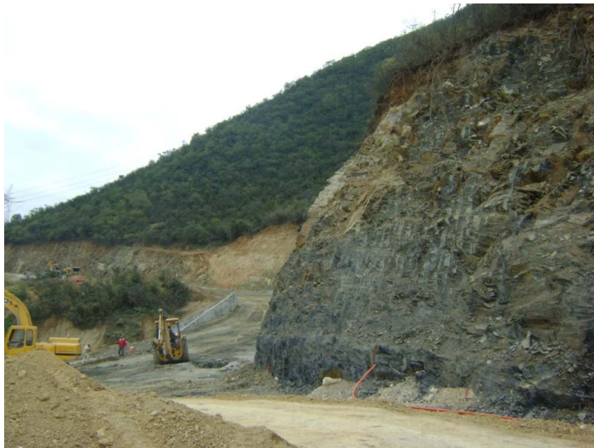
Fotografía 7.5.7.2.5.1. Fracturamiento en el macizo rocoso.
