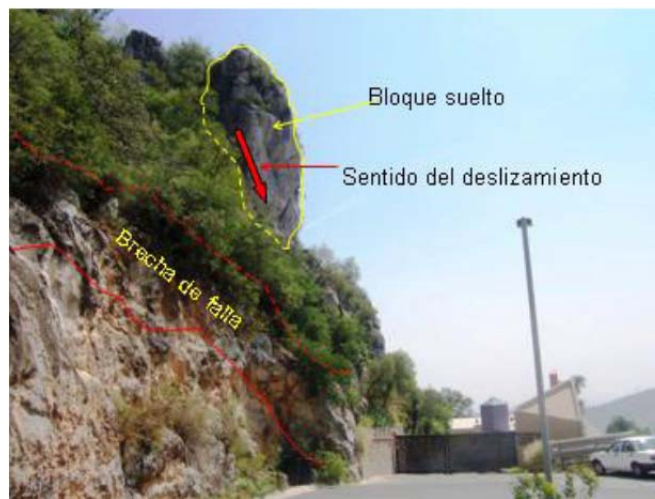
Fotografía 5.1.6a. La posición vertical, dimensión y fracturamiento del bloque, así como el grado de erosión e intemperismo en la base y la inclinación del talud son clara evidencia de la inestabilidad y alto riesgo.
