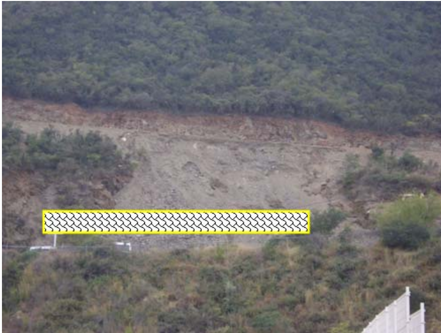
Fotografía 7.5.7.2.7.2. Líneas de gaviones en la base del talud para retener posibles finos.
