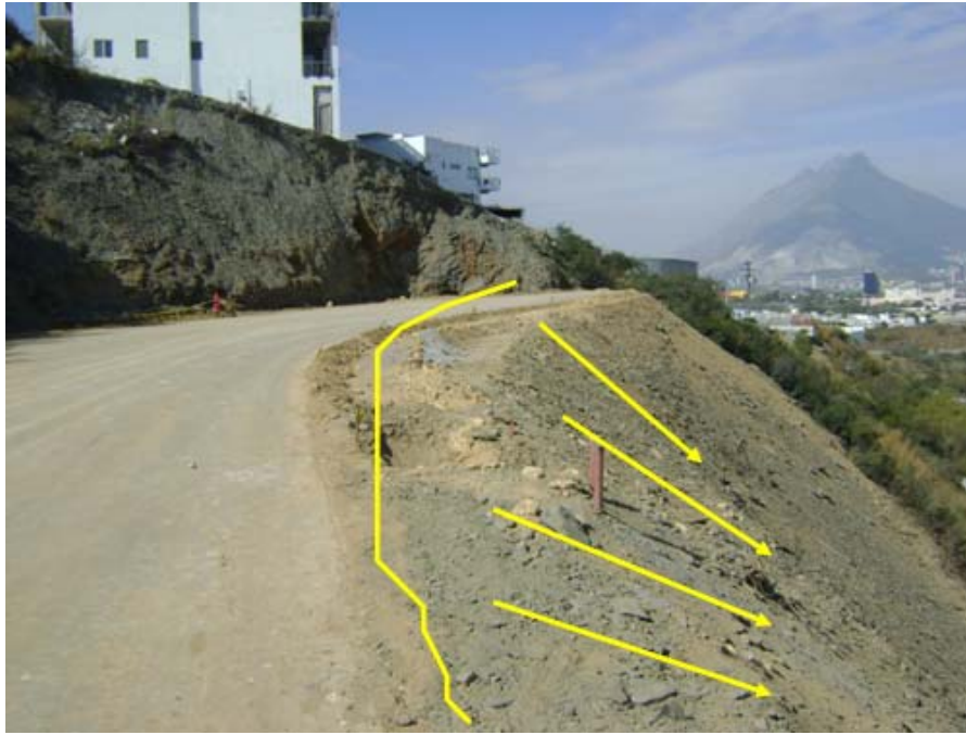
Fotografía 7.5.7.2.2.1. En este sitio la principal causa probable de inestabilidad se debe al material de corte colocado a volteo. En esta zona se tiene un espesor aproximado de 60 cm de material suelto el cual se colocó sobre la roca que aflora de forma natural en el talud.
